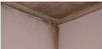
壁・天井の結露によるカビ発生例
